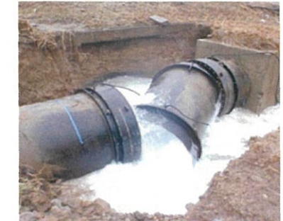
抜けてしまった水道管
