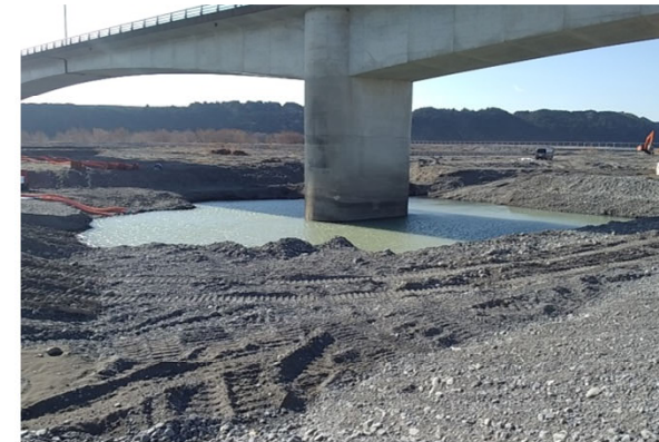
橋脚部湧水状況
