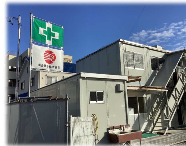
【水洗トイレの導入】 現場事務所・現場共に水洗トイレを導入しました。
